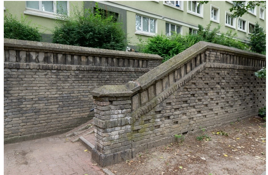
Fot. 90. ul. Dzielna 11, schody wejściowe na górny taras, mur oporowy, balustrada murowana
