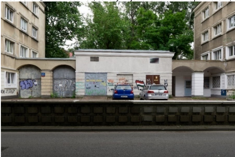
Fot. 95. ul. Nowolipie 27C, stacja transformatorowa z garażami i podcieniami, widok od strony ulicy
